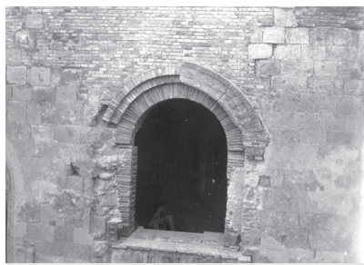
8. A Beatrix-terem kiépített félköríves nyílása az eredeti faragványal, Építészeti Múzeum, Várnai Archívum
